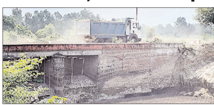
स्वतंत्रभारत, रामनगर बाराबंकी। चौकाघाट डूंगरकामऊ मार्ग पर स्थित कटका पुल लंबे समय से जर्जर अवस्था में है। पुल की खराब हालत को देखते हुए इसके बगल में नए पुल का निर्माण कार्य शुरू किया गया है। निर्माण के लिए की जा रही खुदाई से पुराने पुल की दीवारों की नींव तक नीचे से हिल चुकी है और मिट्टी तक हट गई है जिससे यह पुल और खतर
